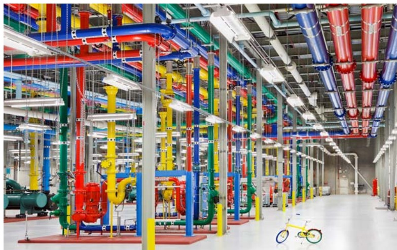
圖 6. Google 資料中心機房裡的冷卻系統，為了能確實幫機房裡面成千上萬台電腦主機降溫，除了採用循環水冷系統外，還依照溫度高低在管線上標示紅、黃、綠、藍四種顏色，甚至還配備腳踏車，以方便工程人員巡查線路。
